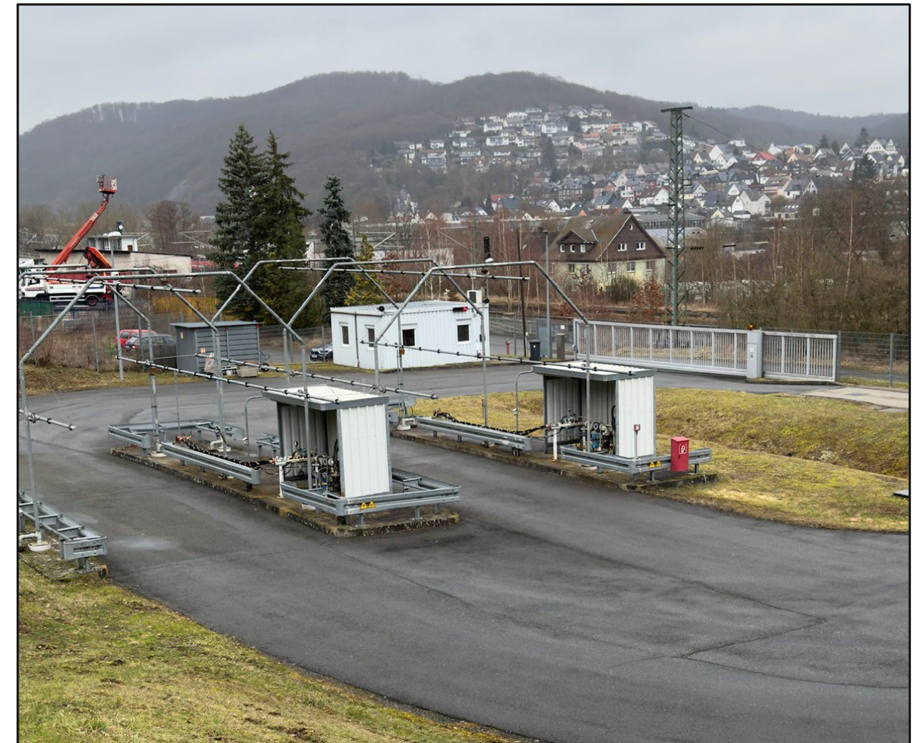
Flüssiggas-Umschlags- und Verteilerlager Sinn
