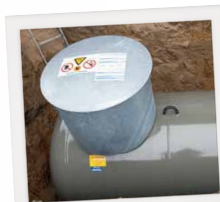
Erdgedeckter Behälter mit Korrosionsschutzbeschichtung
